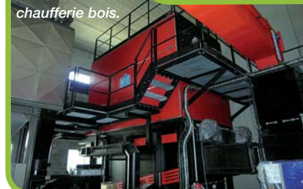
L'intérieur de la chaufferie bois.
