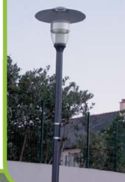
Les nouveaux candélabres installés.
