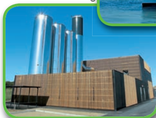
L'une des deux chaufferies de la ville
