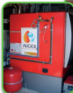
Une chaudière fonctionnant avec des granulés de bois installée à la mairie
