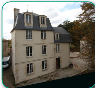
Manoir du XVII e siècle chauffé par une chaudière à granulés de bois de 50 KW
