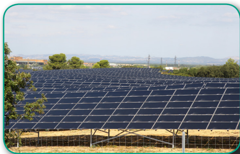
Ferme photovoltaïque Sulauze ©Iviau
