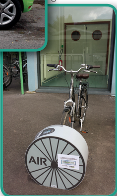
Huit stations de gonflage pour vélos sont installées.
