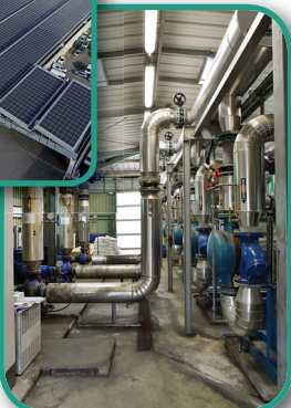
Réseau de Chaleur à Toulouse
